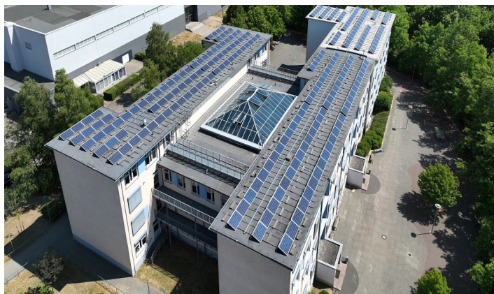
Das Solardach des Schweriner Sportgymnasiums
