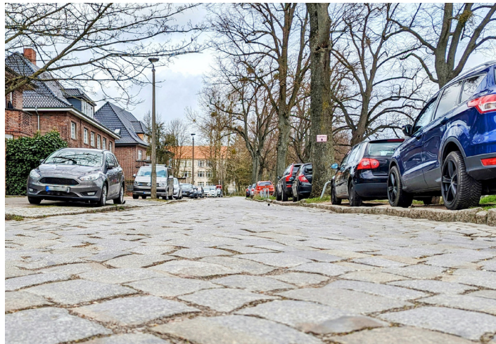
Die Dr.-Hans-Wolf-Straße muss dringend saniert werden. © LHS/Ulrike Auge
