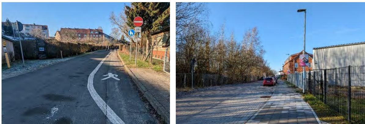
Abbildung 40: Mängel im Fußwegenetz: Mittelweg (links), Hopfenbruchweg (rechts)
