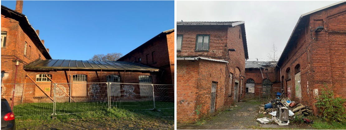
Abb. 27 Mit Folie geschütztes Dach der denkmalgeschützten Leerwerkstatt (links), in Teilen eingefallenes Dach des denkmalgeschützten Werkstattgebäudes auf U-förmigen Grundriss (rechts)
