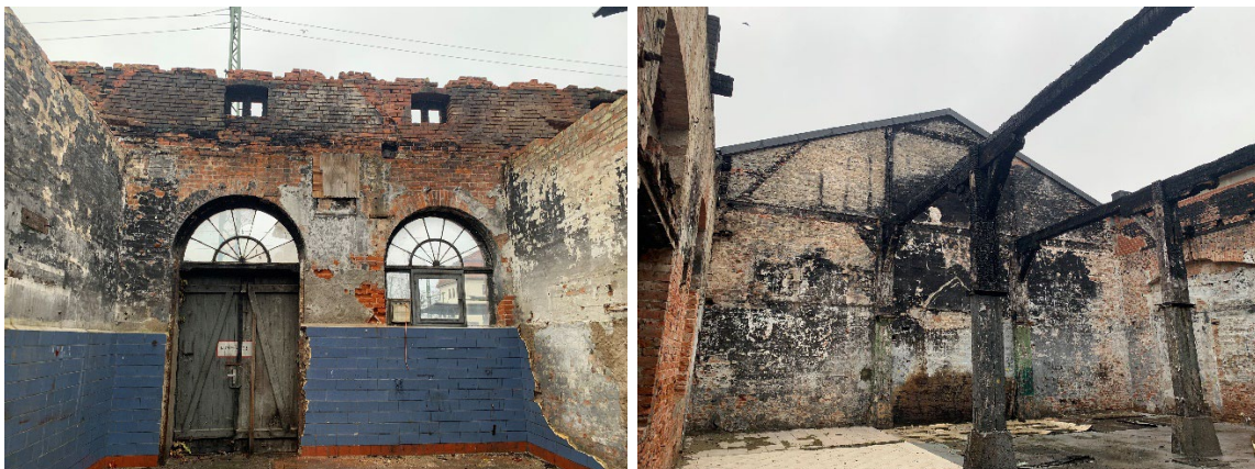
Abb. 11 Entkernter denkmalgeschützter Teil des Eisenbahnmuseums nach Brand
