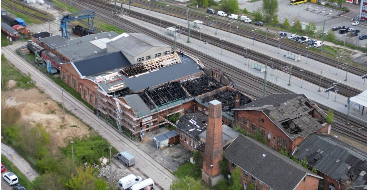
Abb. 24 Gebäude des Museums nach dem Brand, erkennbar auch der Verfall des Dachs des denkmalgeschützten Nachbargebäudes, Bild: Ingenieurbüro HTG, 2024
