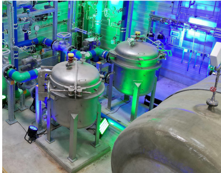
Die Geothermie-Anlage der Stadtwerke Schwerin liefert grüne Wärme für die Landeshauptstadt. © Stadtwerke Schwerin GmbH (SWS)
