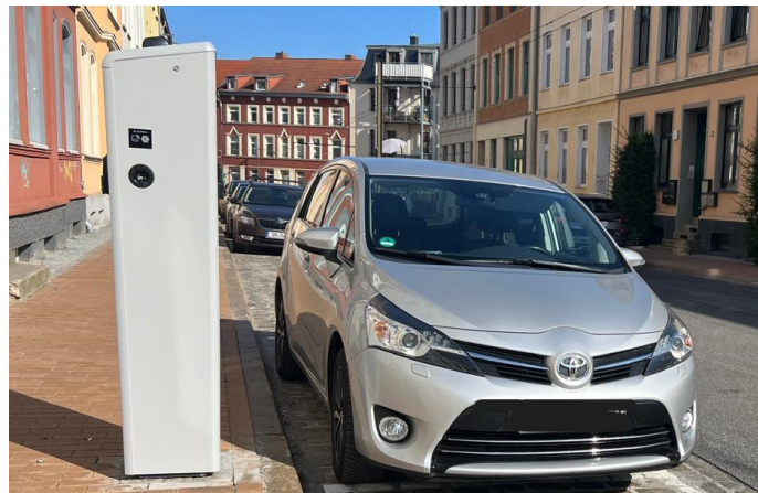
Neue E-Ladestation in der Franz-Mehring-Straße
