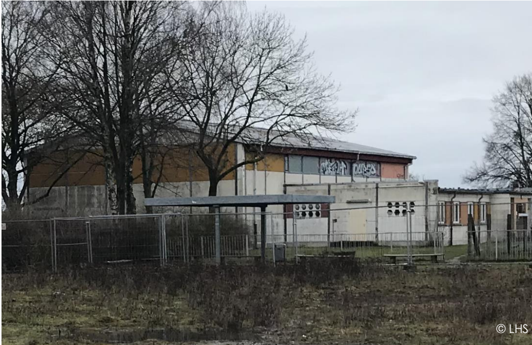
Vorhandene Turnhalle, Sanierung erforderlich (Stand: 20.01.2021)
